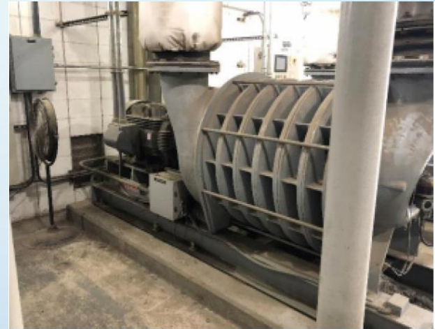
Fan Cooling Blower No. 2
